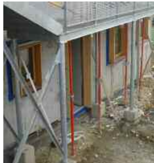
La coursive est autoportante et indépendante de la façade en béton armé.
