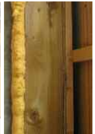
Détail liaison ossature bois/béton : la liaison est étanchéifiée par collage du freine vapeur et du pare-pluie sur le refend béton. La mousse de polyuréthane constitue une barrière complémentaire par calfeutrement des interstices entre bois et béton.
